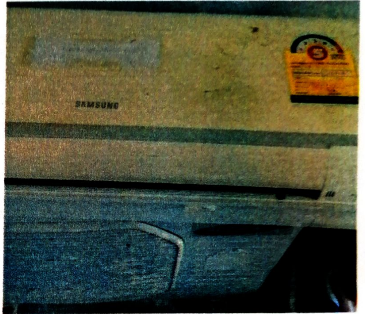
7. 420-56-0010 เครื่องปรับอากาศ
